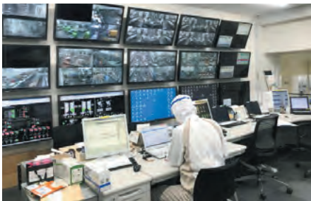
コントローラー室
